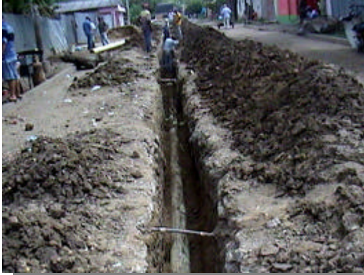
Foto 25. Reemplazo de tuberías de alcantarillado en la zona urbana, sector del mercado público.
