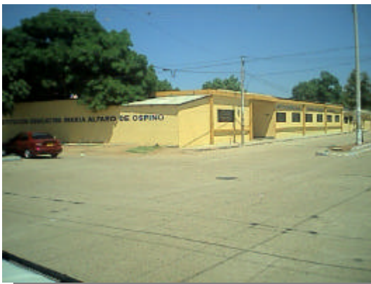
Foto 3. Fachada de la Institución Educativa María Alfaro de Ospino después de su remodelación.
