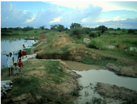
Foto 51. Dique fracturado antes de la reconfirmación.
