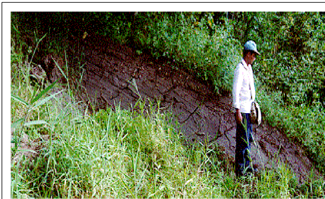
Foto 2. Detalle del Flanco Izquierdo del deslizamiento, donde se observa el desplazamiento vertical.
