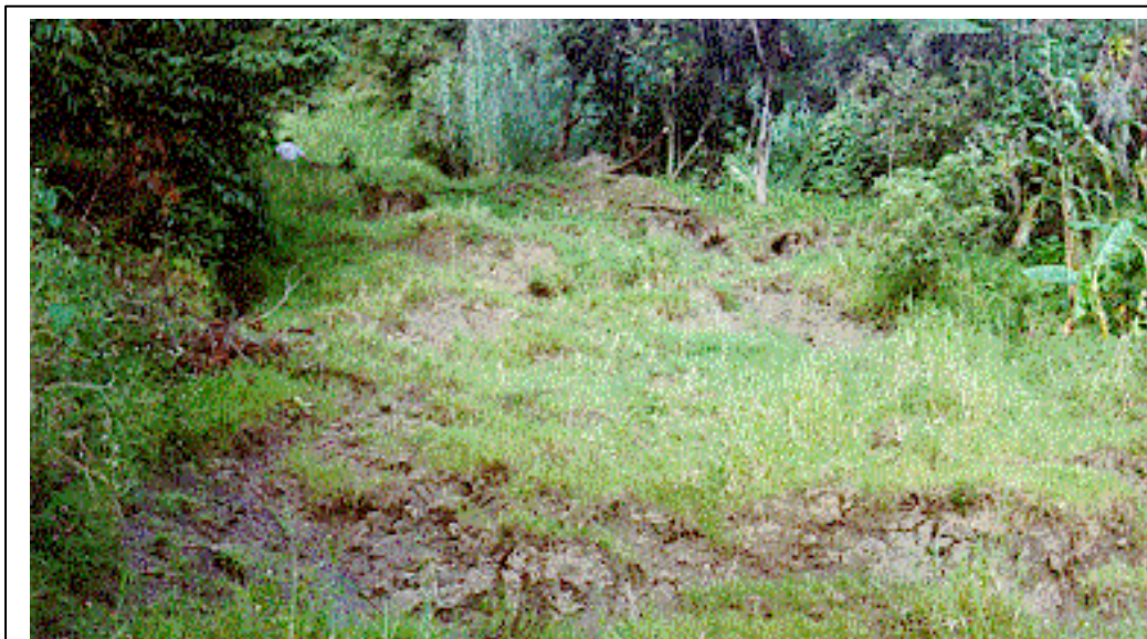
Foto No. 1. Panorámica del deslizamiento de la Vereda Barro Blanco Abajo. Se observan los movimientos diferenciales del suelo por efecto del avance retrogresivo del deslizamiento desde la quebrada la Guaya, los cuales han destruido la vía.
