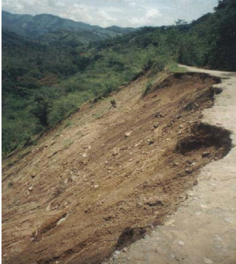
MOVIMIENTO EN MASA QUE AFECTA LA VIA QUE DE RIOBLANCO CONDUCE A LA VEREDA DE BOCAS
