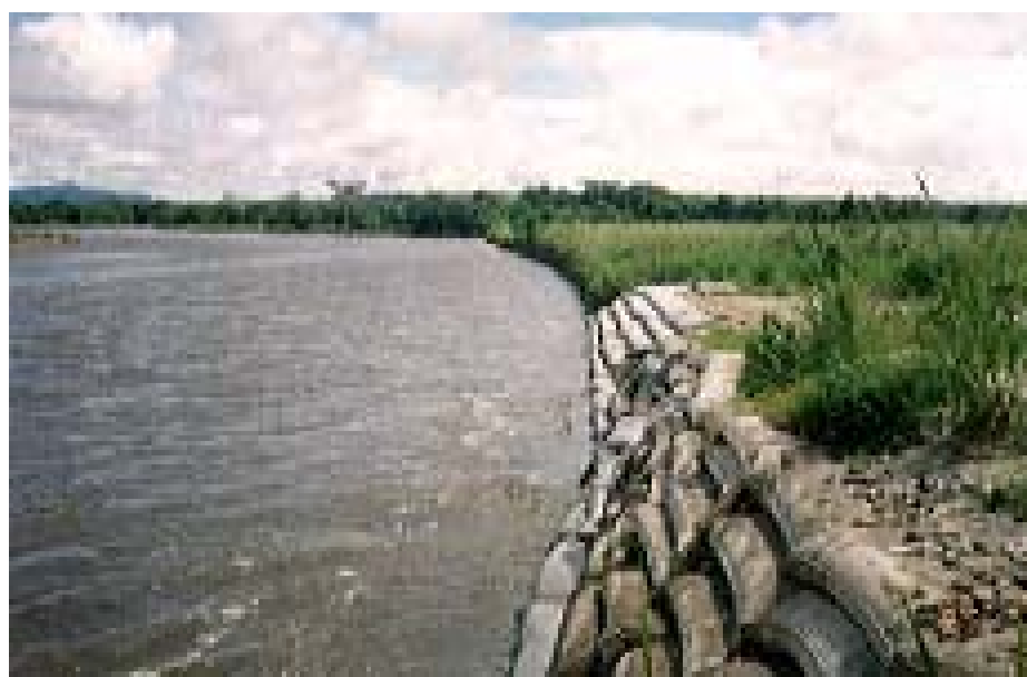
Foto N 13, Obras Geotécnicas de protección de las márgenes del Río Upía, conformando un dique longitudinal, sobre la margen izquierda en un sector de fuerte erosión.
