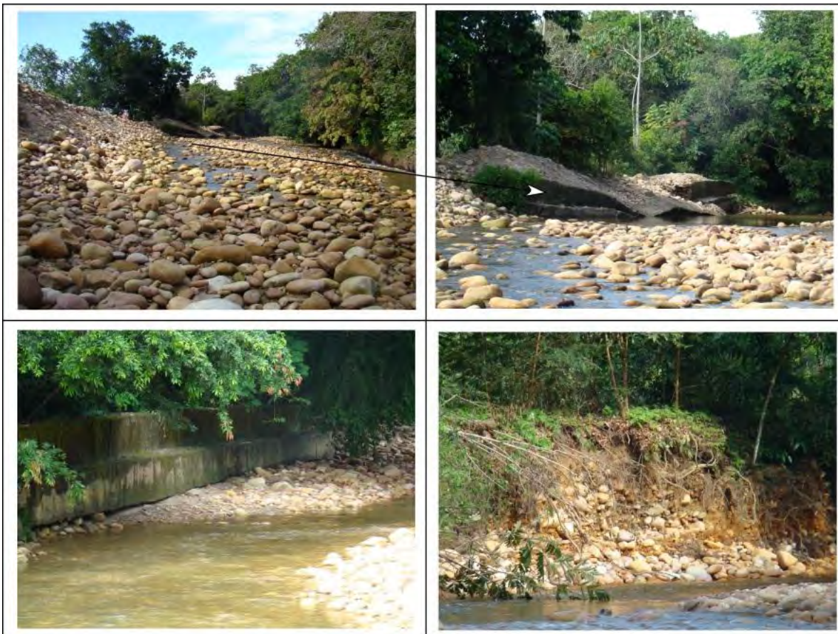
Detalle de las orillas y las obras en gaviones con problemas.
