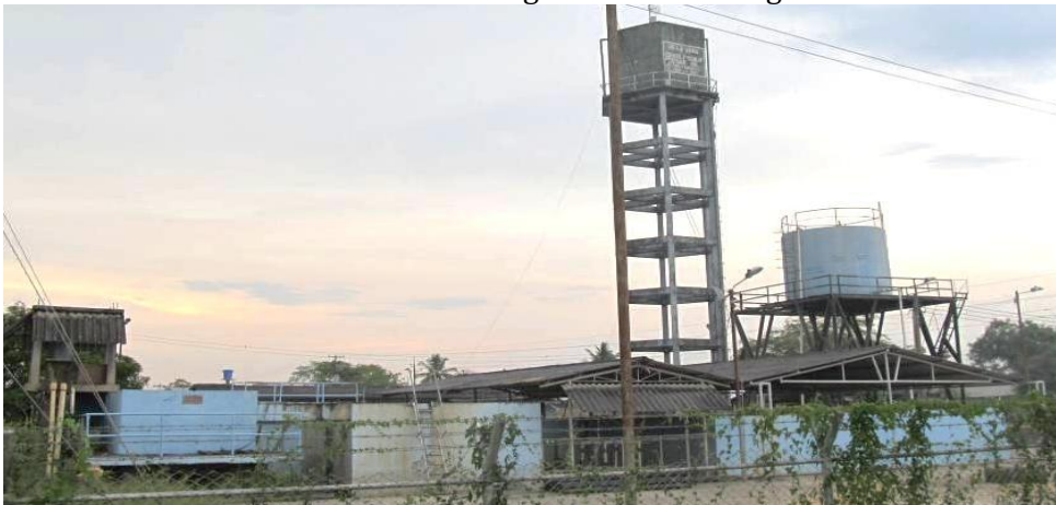
Gráfico 27. Planta de Tratamiento de Agua Urbana Cantagallo
