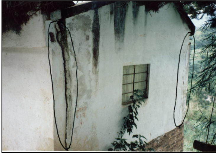
Fotografía 8. Agrietamiento vivienda ubicada en la vereda Cora Chiquito
