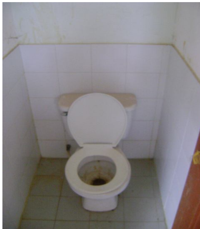
Baños escuela rucha
