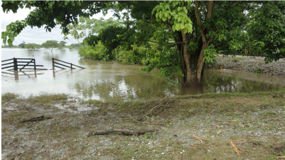
Tubería de drenaje del Ferrocarril diámetro 2.0 m totalmente cubierta
