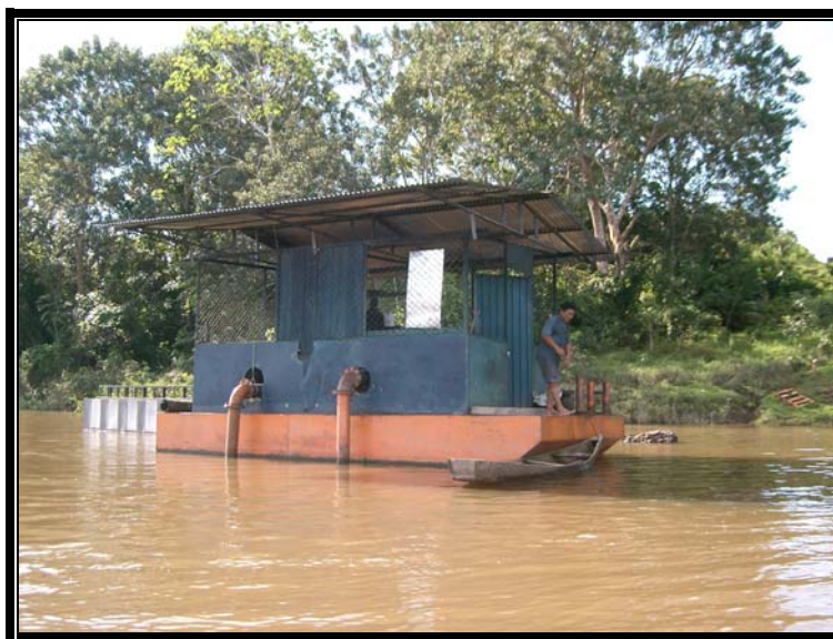
Figura 67. Balsa flotante captación de agua
