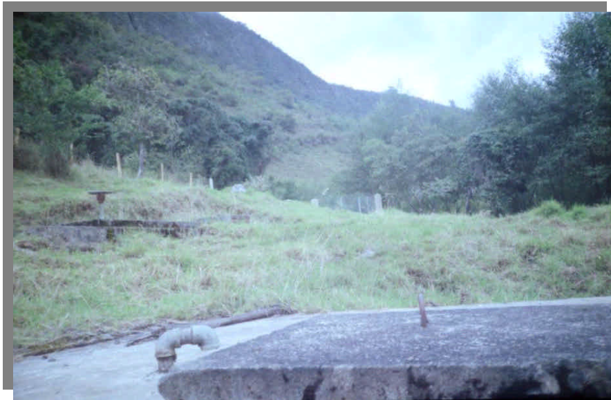
Fotografía 14.1. Tanque regulador del Acueducto Urbano.
