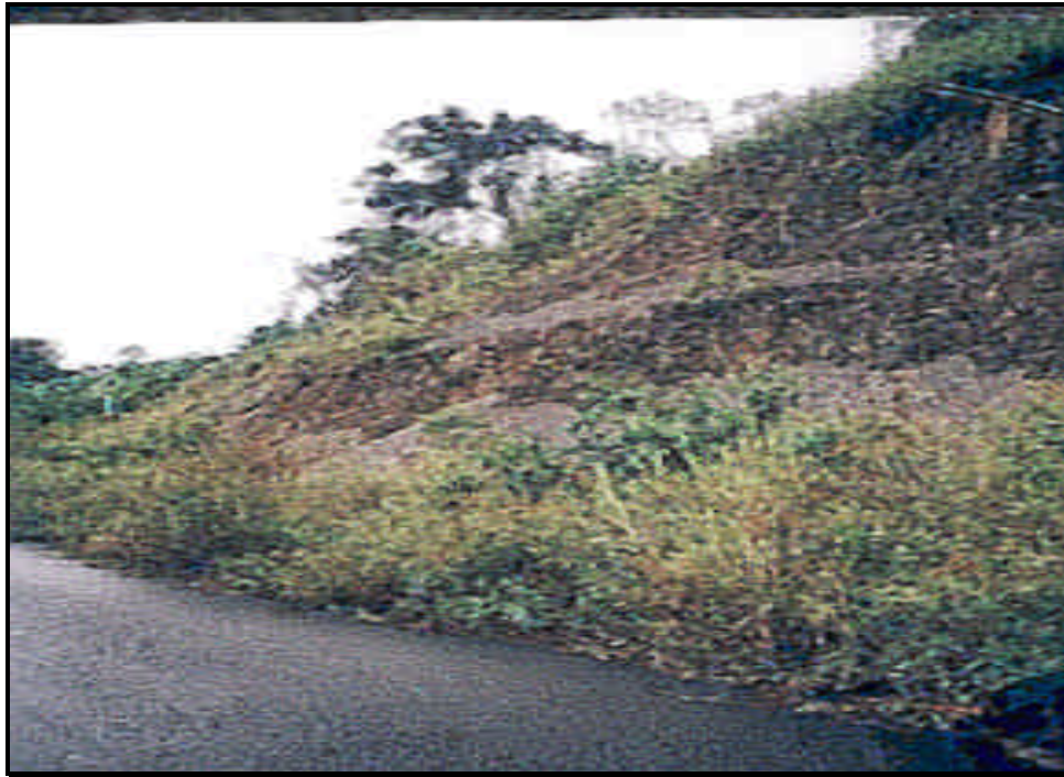
Figura. 2: Afloramiento de lutitas negras, en al vía Cunday – Villarrica, sector Los Alpes.
