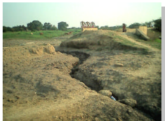
Foto 28. Deterioro del dique en tierra causado por el embate de las aguas del caño Plato.
