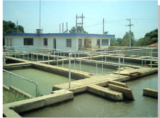
Foto 14. Planta de tratamiento de agua e instalaciones de dosificación
