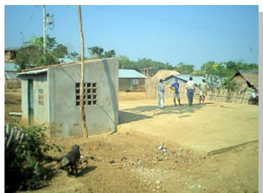
Foto 18. Caseta de bombeo y tanque de compensación enterrado en el barrio Las Mercedes
