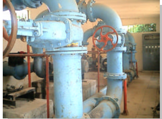
Foto 16. Cuarto de máquinas e instalaciones eléctricas
