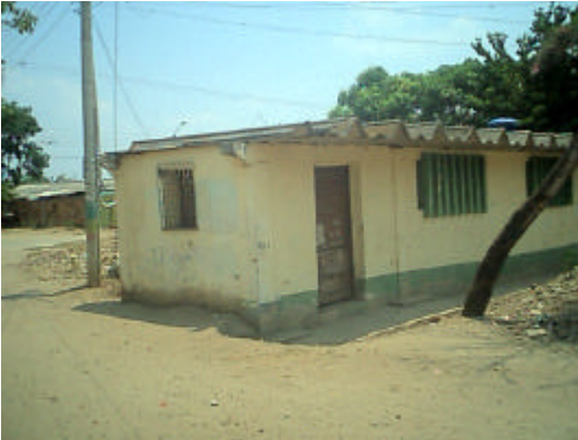
Foto 21. Caseta de bombeo de aguas negras en el barrio Florida.
