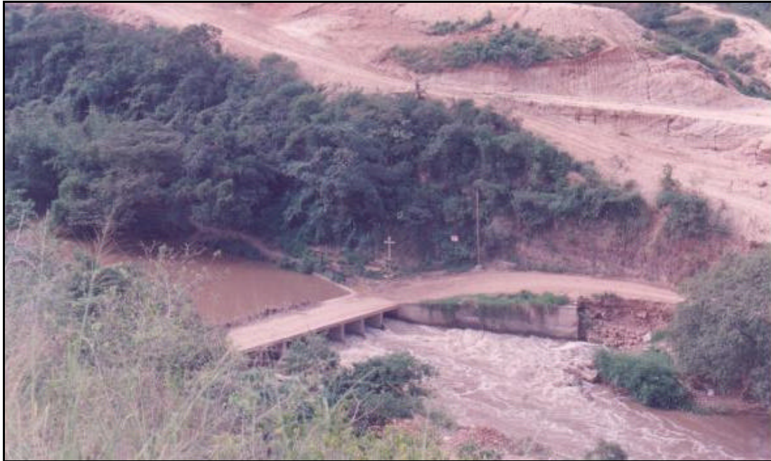
Fotografía 18. Puente sobre el río de Oro. Estructura vial convertida en presa por la obstrucción con residuos vegetales. Se aprecia el cambio de la hidrodinámica del río en la parte alta con flujo lento del cauce y la parte inferior de la presa con flujo rápido (CER, UIS, 1999).
