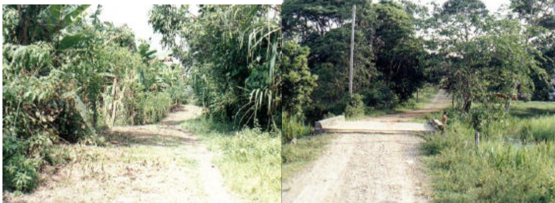
Fotografía 13: Vías intermunicipales petrolizadas y vías interveredales con poco mantenimiento
